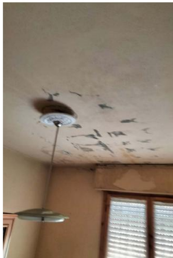
Soffitto Locale Cucina
